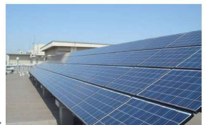
太陽光パネル
