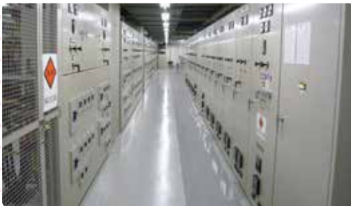
製品の配電盤
