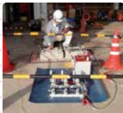
絶縁耐力試験
