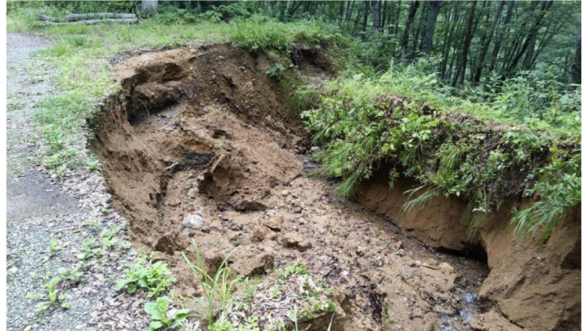
林道崩壊 — 路肩崩落
