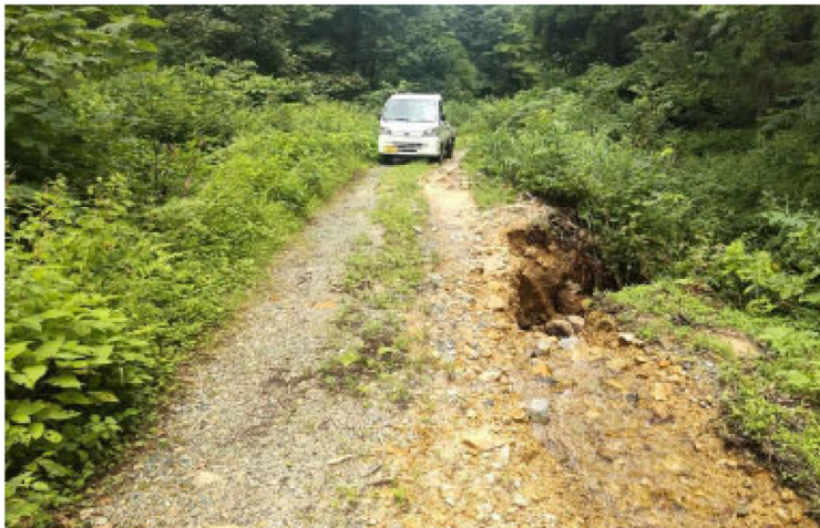
林道崩壊 — 路肩崩落
