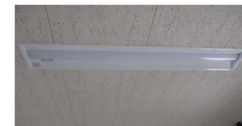
▲照明器具（改修後・LED照明器具）
