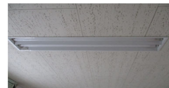
▲照明器具（改修前・HF照明器具）
