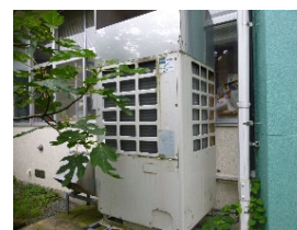
▲第一種特定製品確認（空調機・附属幼稚園）
