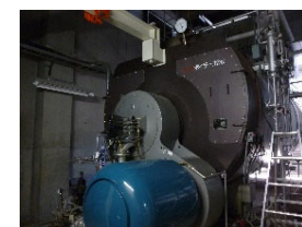
▲中央設備機械室・ボイラ設備（飯田キャンパス）
