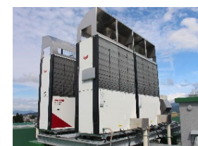
▲屋上空調設備（室外機）
