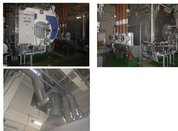
▲2019年度に更新したボイラー設備・煙道（小白川キャンパス）
