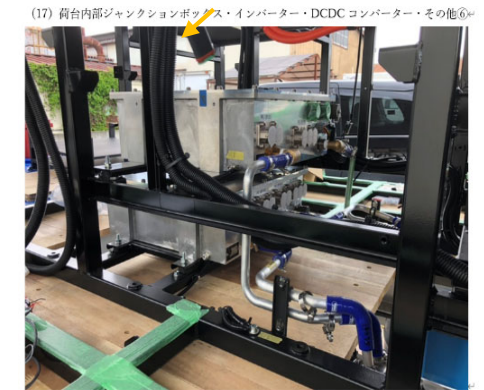
(17) 荷台内部ファンクションボックス・インバーター・DCDCコンバーター・その他6台
