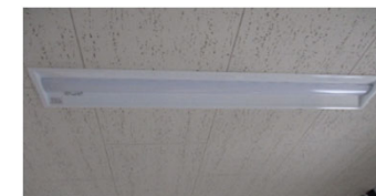
▲照明器具（改修後・LED照明器具）
