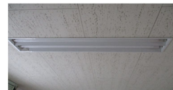
▲照明器具（改修前・HF照明器具）
