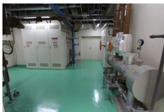
▲設備機械室内部 ◀動物実験センターA棟外観写真
