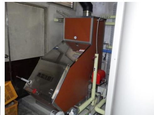
▲整備後のバイオマスボイラ（薪焚温水ボイラー）
