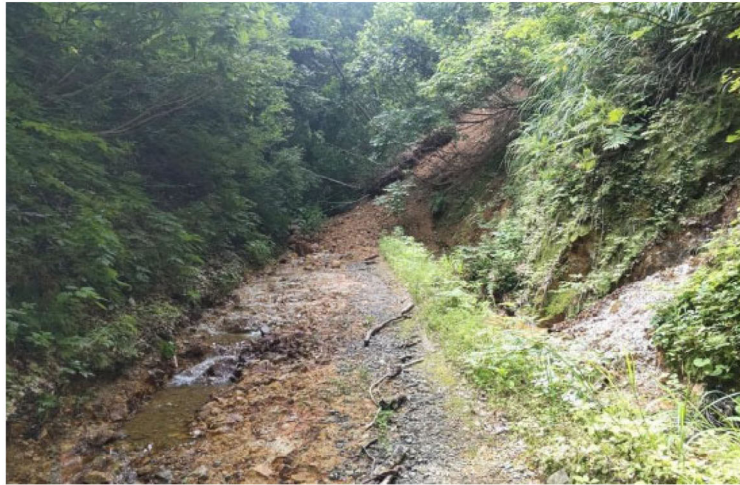
林道 — 法面崩落
