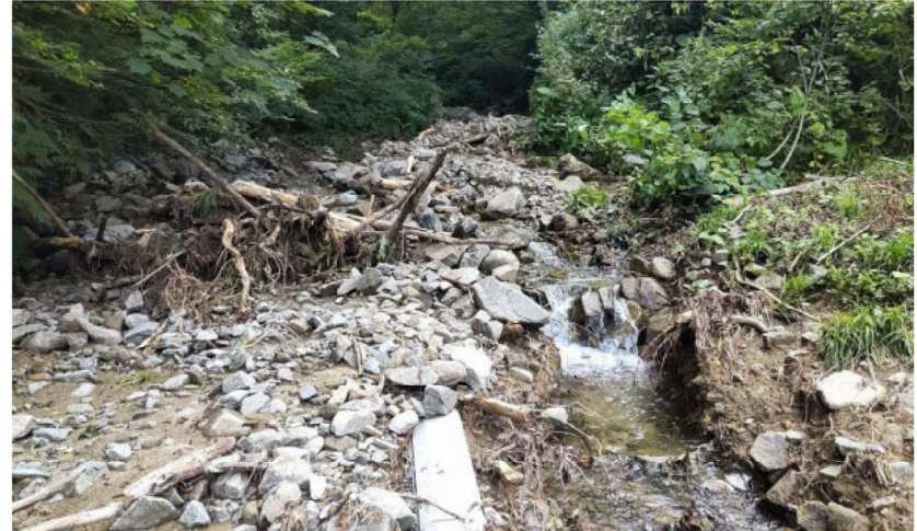
林道 — 土砂流入
